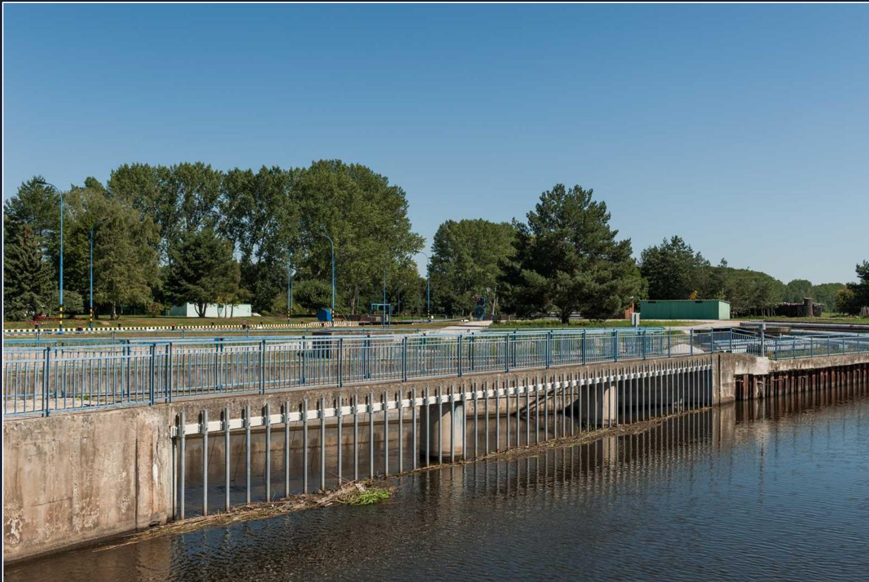
Nátok do malé vodní elektrárny je osazen hrubými česlemi.
