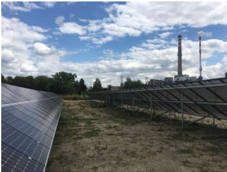
Obr. 4 Detail fotovoltaické elektrárny s akumulací Teplárny Planá nad Lužnicí
