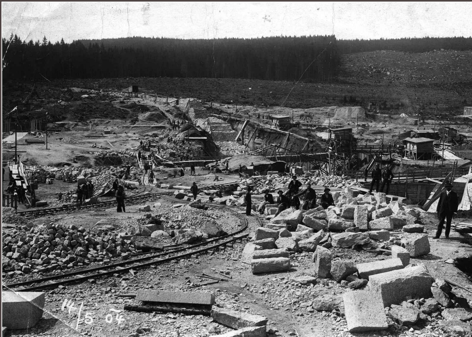
Stavební práce na přehradě Bedřichov proběhly v letech 1902-1905. Stavbu prováděla firma Ackermann z Klagenfurtu, později W. Relle und Neffe, W. Streizig und CO. Snímek je datován 14. 5. 1904.
