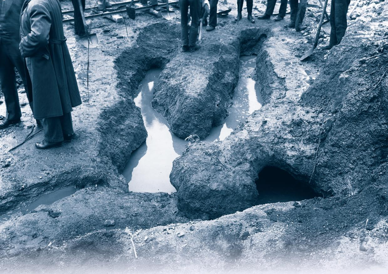
Obr. 63. Souš, průsakové cesty v patě hráze, 1925
