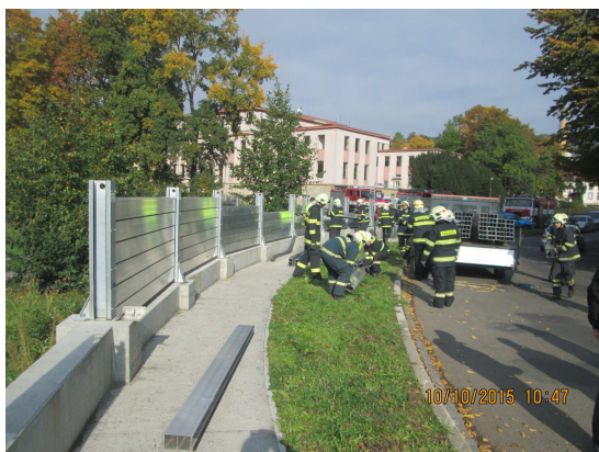
Obr. 1 : Cvičná instalace mobilního hrazení v Děčíně
