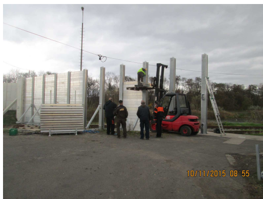
Obr. 4 : Cvičná instalace mobilního hrazení na Lovosicku
