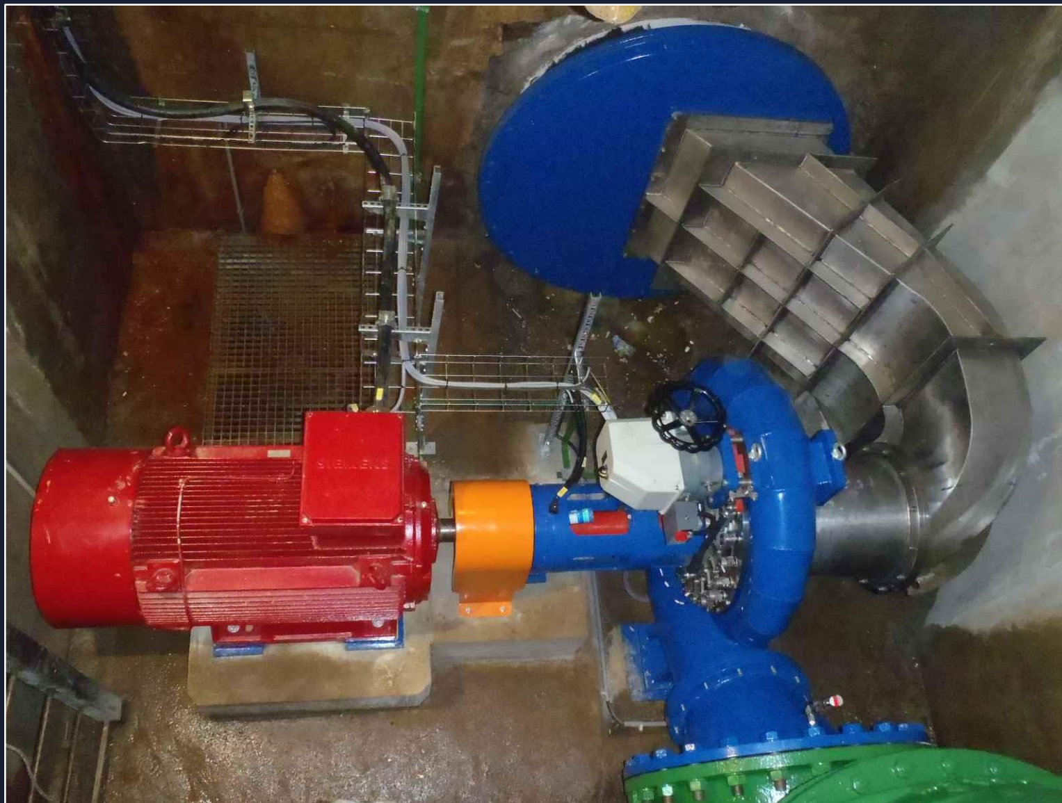
Malá vodní elektrárna s jednou Francisovou turbínou, instalovaným výkonem 147 kW a spádem 37,4 m je umístěna v dolní strojovně sdruženého objektu.
