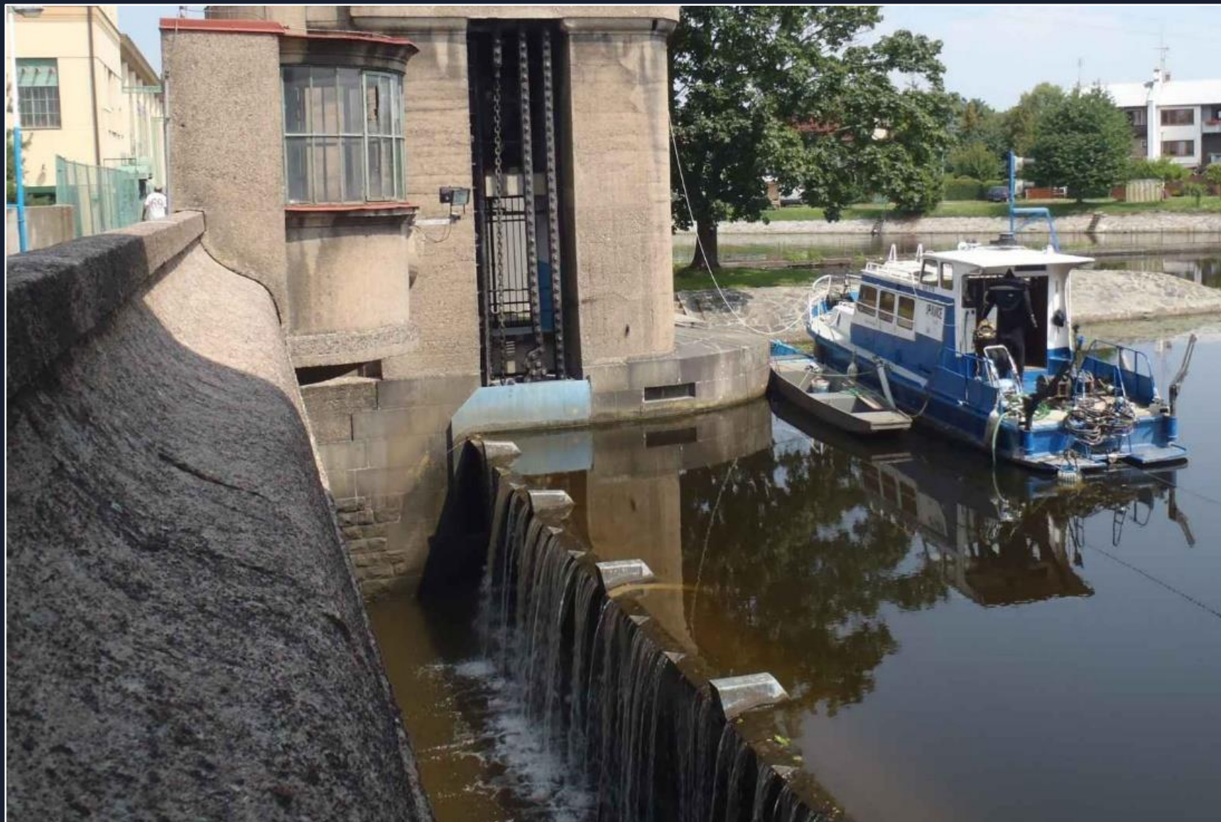
Jezová pole jsou hrazena zdvižnými stavidly s nasazenými dutými klapkami.
