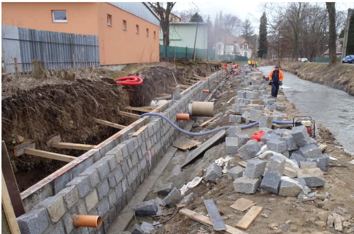
Obr. č. 2: Probíhající práce na obnově vodního toku Jeřice v Chrastavě (duben 2013)
