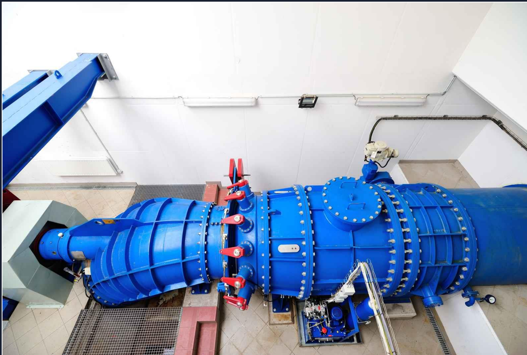
Ve strojovně je umístěna jedna přímoproudá horizontální Kaplanova turbína s automatickou regulací. Její maximální hltnost je 5,2 m 3 /s a instalovaný výkon 675 kW. Turbína pracuje v rozsahu spádu 8 – 17 m.
