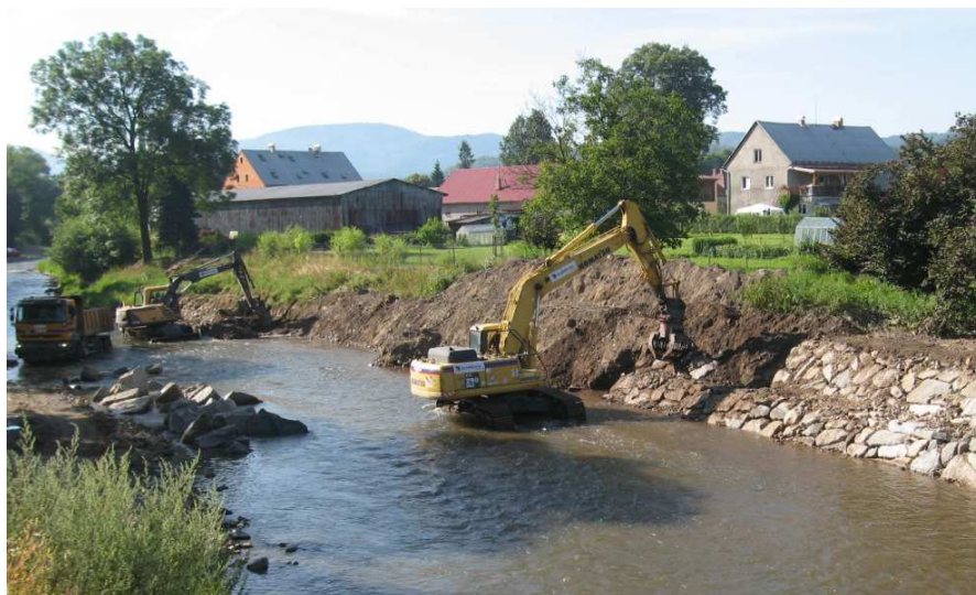
Obr. č. 3: Probíhající práce na obnově vodního toku Lužická Nisa v Hrádku nad Nisou
