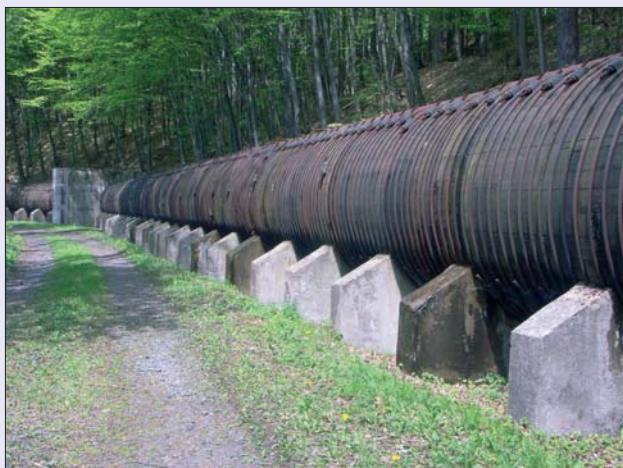
Obr. 77 Dřevěný přivaděč na vodní elektrárnu Seč, 2006
