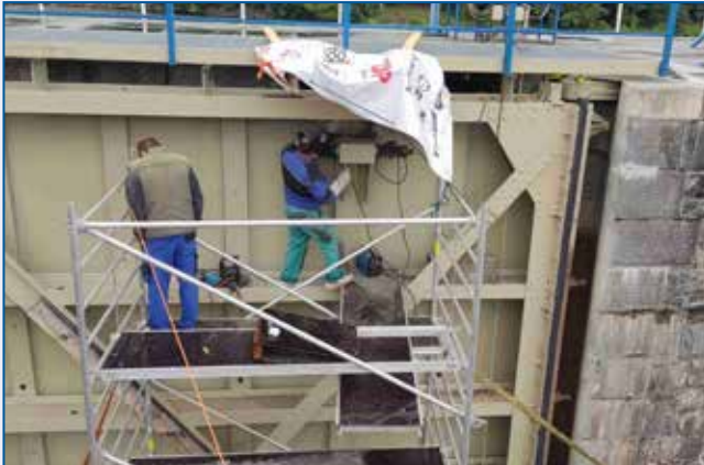
~ VD Klavary, oprava prasklin
