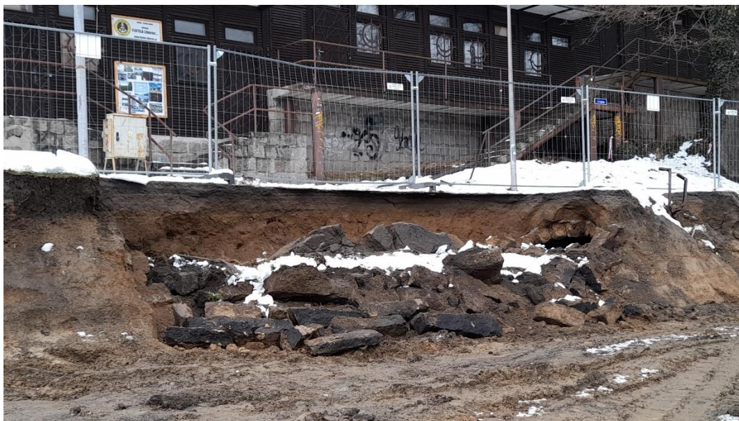
Propadlá část náhonu pod promenádní cestou
