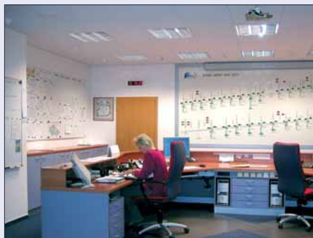
Pracoviště vodohospodářského dispečinku v Hradci Králové
