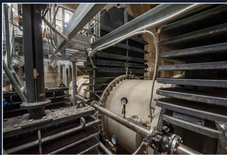
Potrubí spodních výpustí
