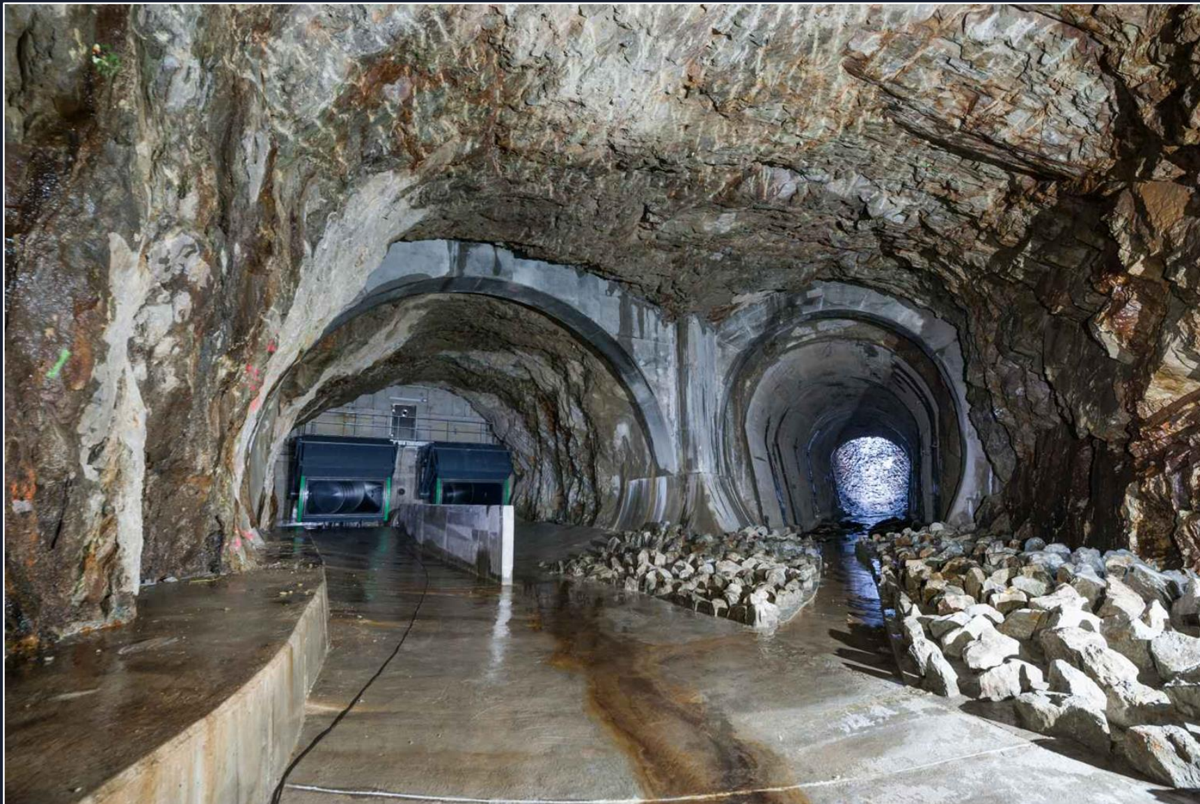
Za účelem zvýšení bezpečnosti přehrady při povodni byla v letech 2017-19 provedena rekonstrukce spodních výpustí.
