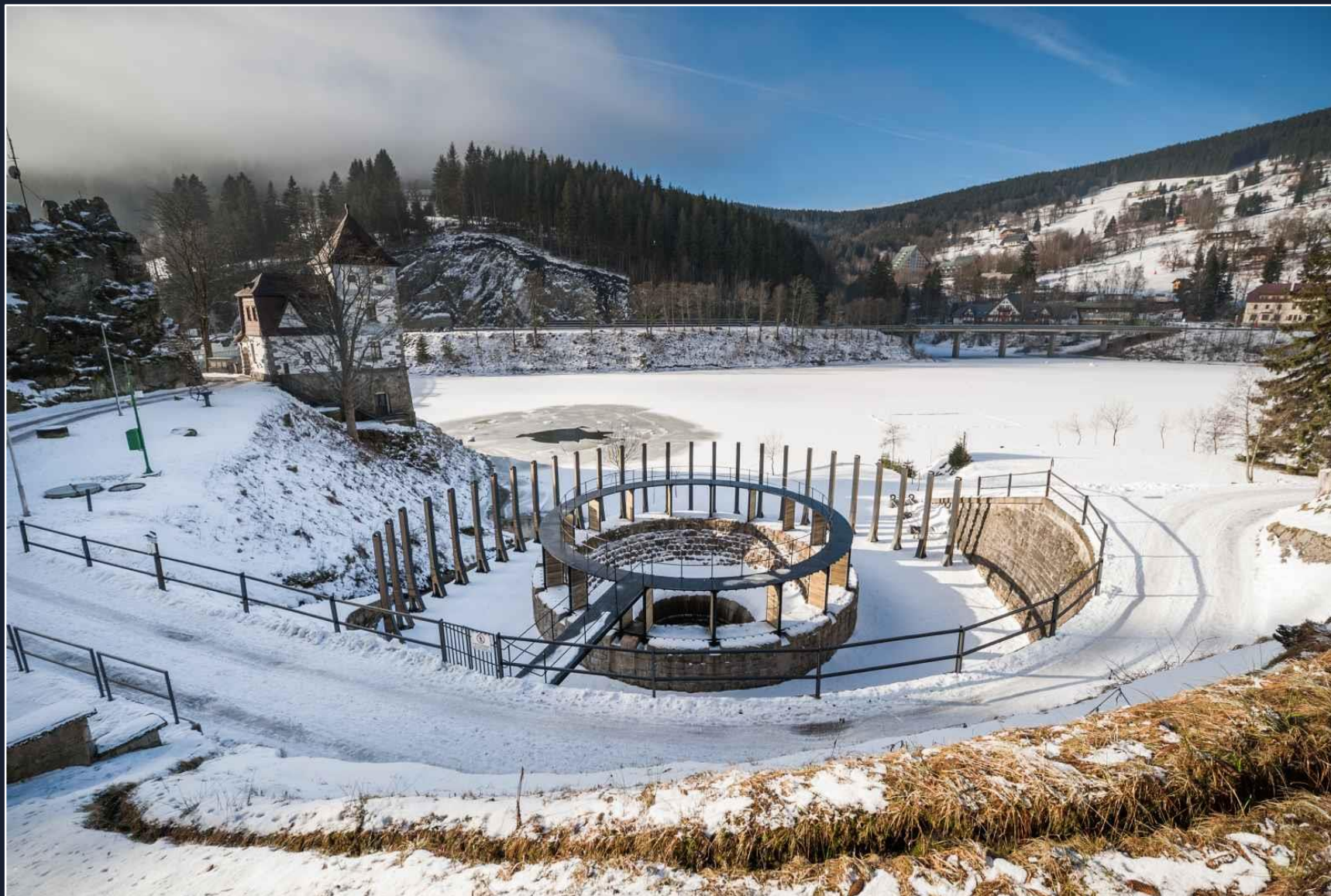
Šachtový přeliv u levého břehu nádrže za bývalým domkem hrázného je zděný z lomového kamene. Kruhová svislá odpadní šachta má průměr 5 m a je zaústěná do obtokového tunelu.
