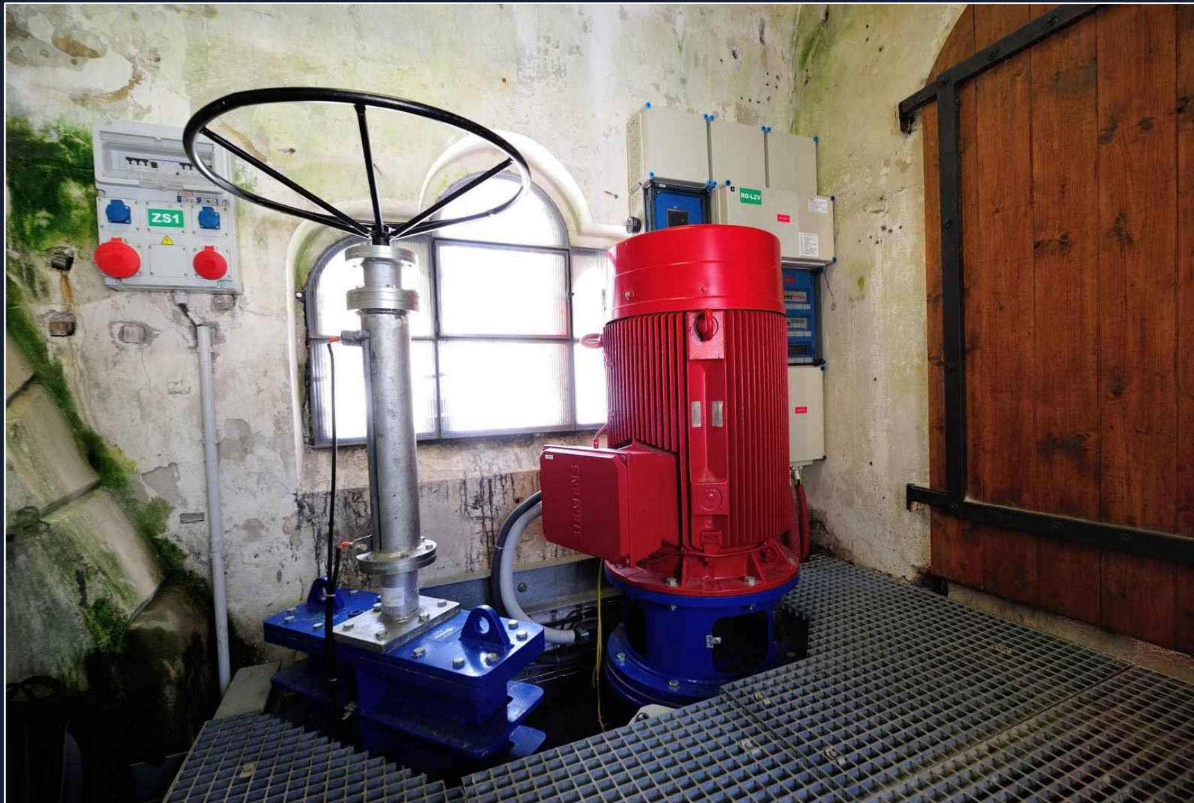
Malá vodní elektrárna s Francisovou turbínou je umístěna na odbočce z levé základové výpusti.
