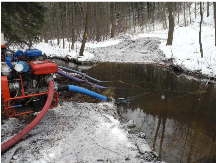
Čerpadla na obtoku nad kontaminovanou lagunou na toku Zlatník
