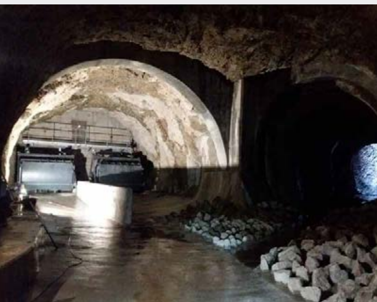
▲ Rozplet v odtokové komoře – současný stav
