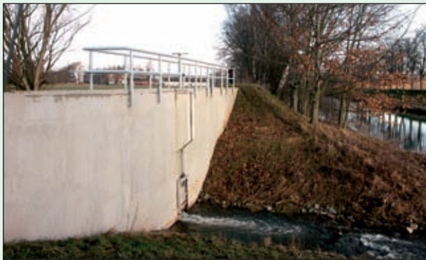
Obr. 92 Inundační uzávěr na výtoku Velkého labského náhonu do Labe
