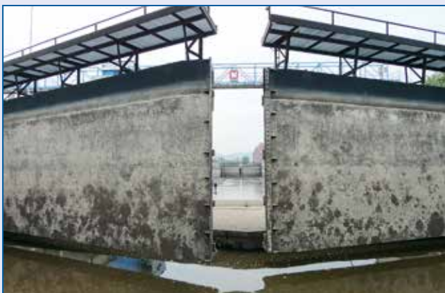
Vyčerpaná velká plavební komora Lovosice
