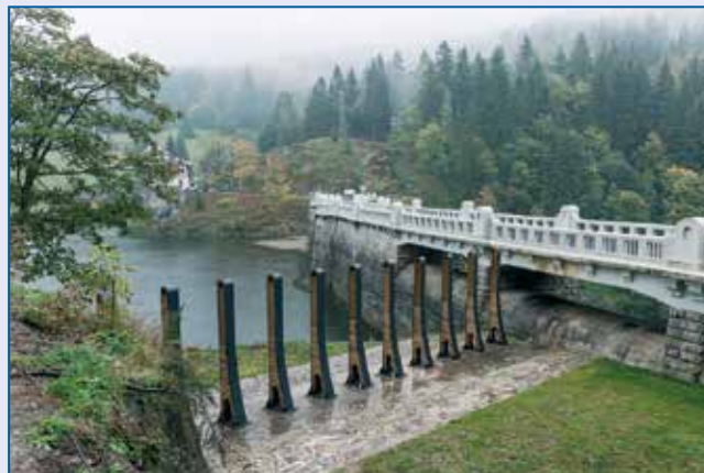
Nové česle před korunovým přelivem na přehradě Labská
