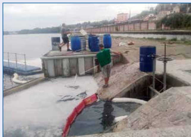
Likvidace ropné havárie na havarijním profilu Roudnice nad Labem
