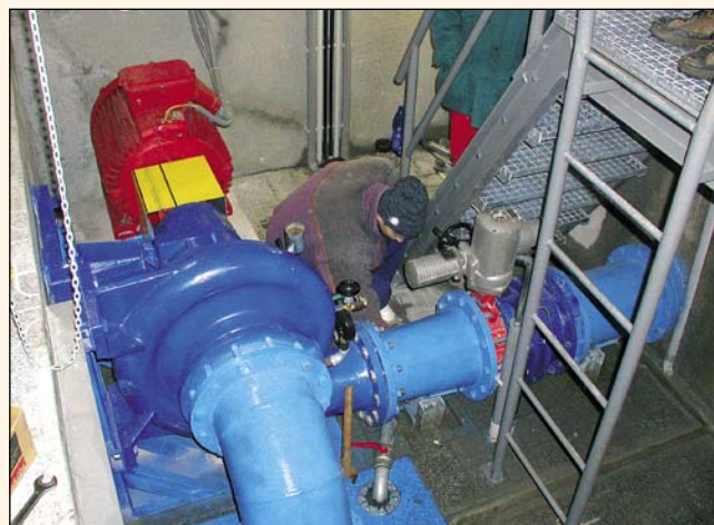
MVE na VD Souš uvedená do provozu v roce 2003.
