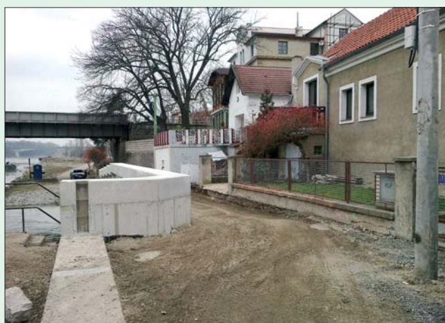
Labe, protipovodňová ochrana zástavby na Mělníce
