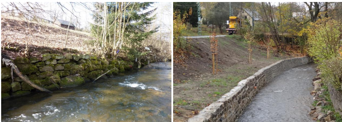
Obnovená levobřežní zeď s částečnou náhradní výsadbou pod silničním mostkem cca 200 m nad areálem firmy TERMIL
