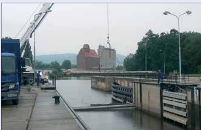
VD Lovosice, provizorní hrazení malé plavební komory
