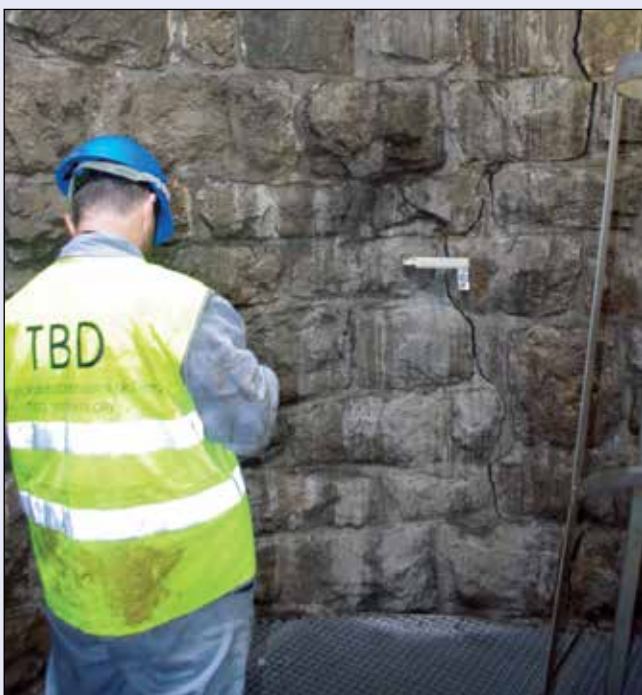
VD Labská, měření trhliny ve zdivu levé šoupátkové věže
