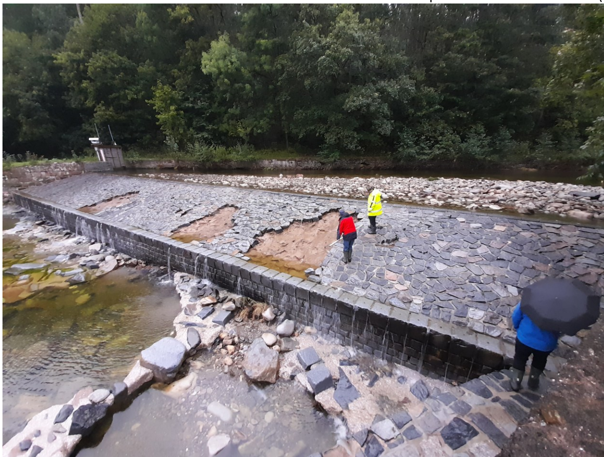
Obr. 13 – Labe, Vrchlabí – poškozená přelivná plocha a vývar jezu Vodog
