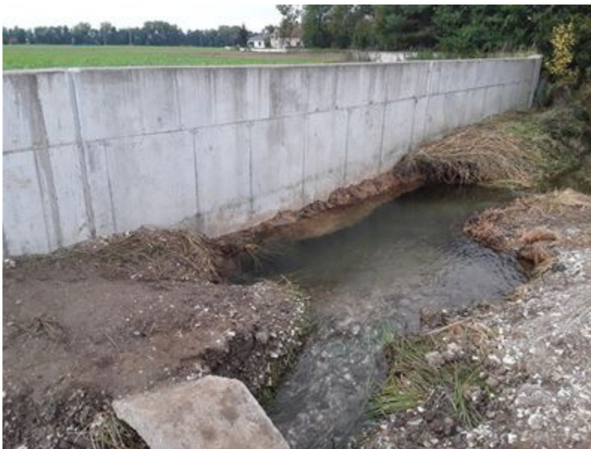
Obr. 14 – Novohradka – PPO Čankovice – místo porušení podloží ochranné zď
