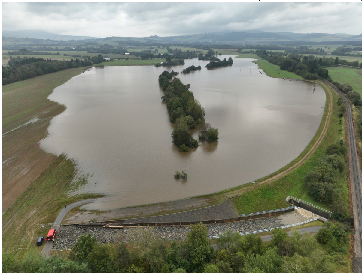
Obr. 1 – SN Dolní Lipka 15.9.2024 s poškozením opevnění bezpečnostního přelivu
