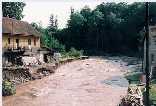
Dědina, zničené koryto v Žákovci
