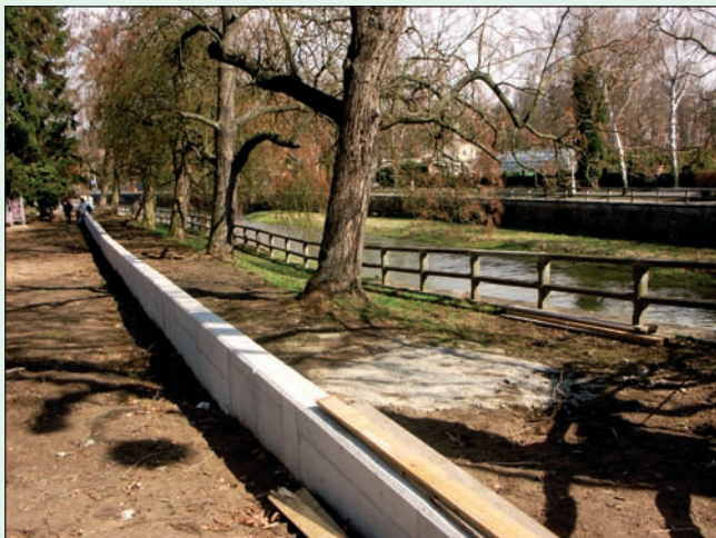
Tichá Orlice, protipovodňové opatření v Chocni
